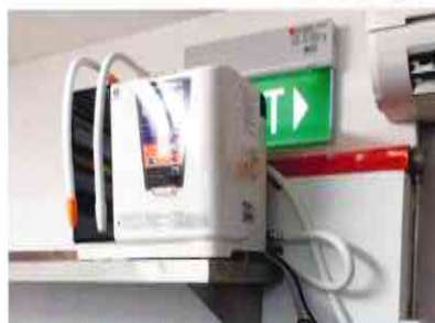
LeveLuk SUPER 501 installed in the kitchen area. 調理場に設置されたスーパー501
